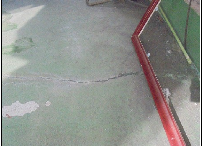
備考 床面のひび割れ
