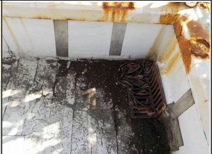
備考 防水層ひび割れ・ドレンの詰まり・笠木の錆
