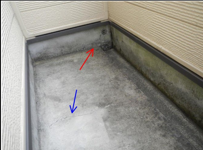
備考 防水保護層のひび割れ
