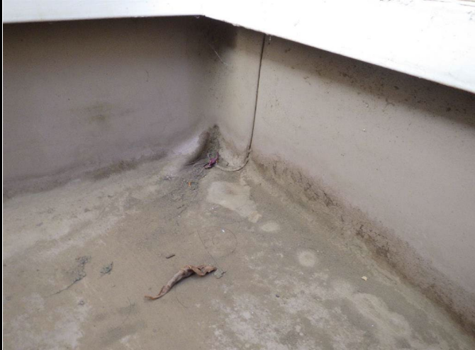
備考 防水保護層の膨れ
