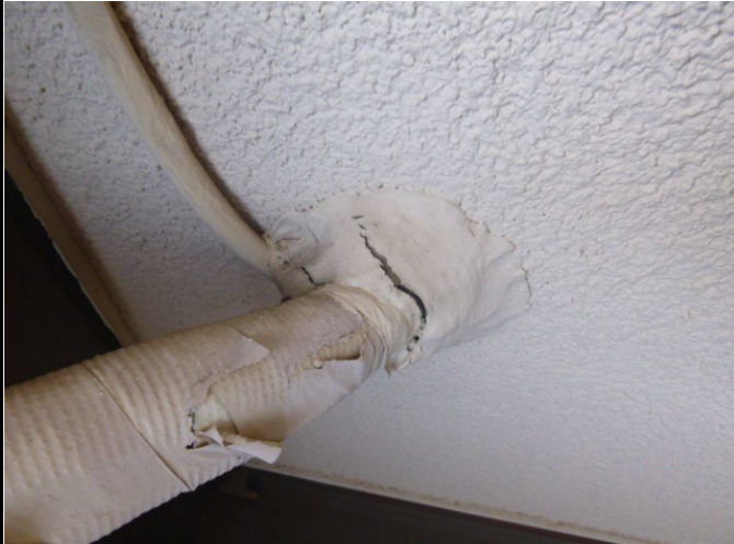
備考 配管貫通部パテの破断
