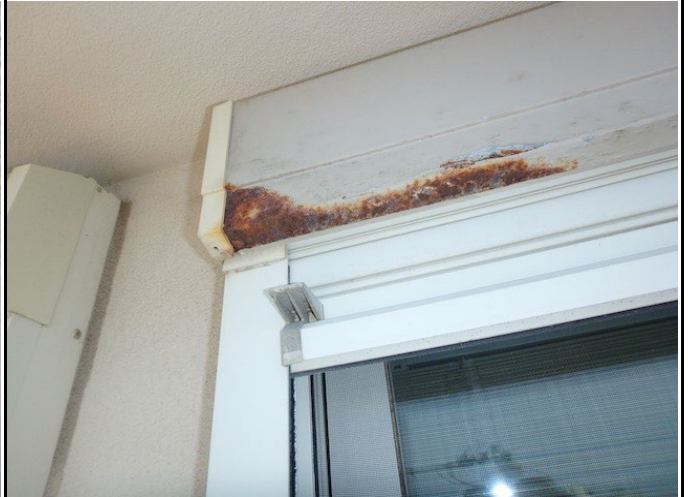
備考 外装シャッター鉄部の錆
