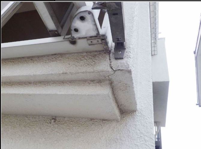
備考 外装材の著しいひび割れ
