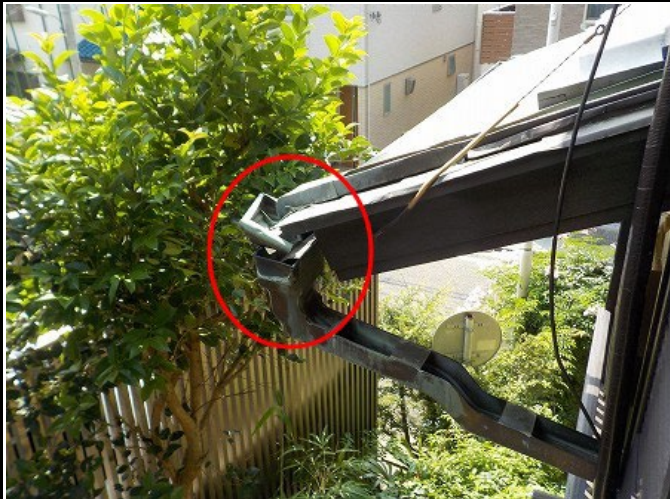
備考 樋の破損
